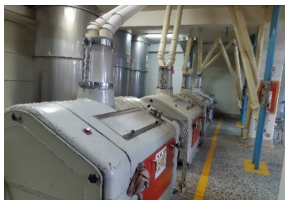
FOTO 3. BANCOS DE MOLIENDA
