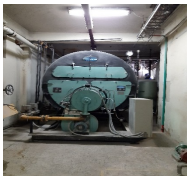
FOTO 11. CALDERA COLMAQUINAS 300 BHP
